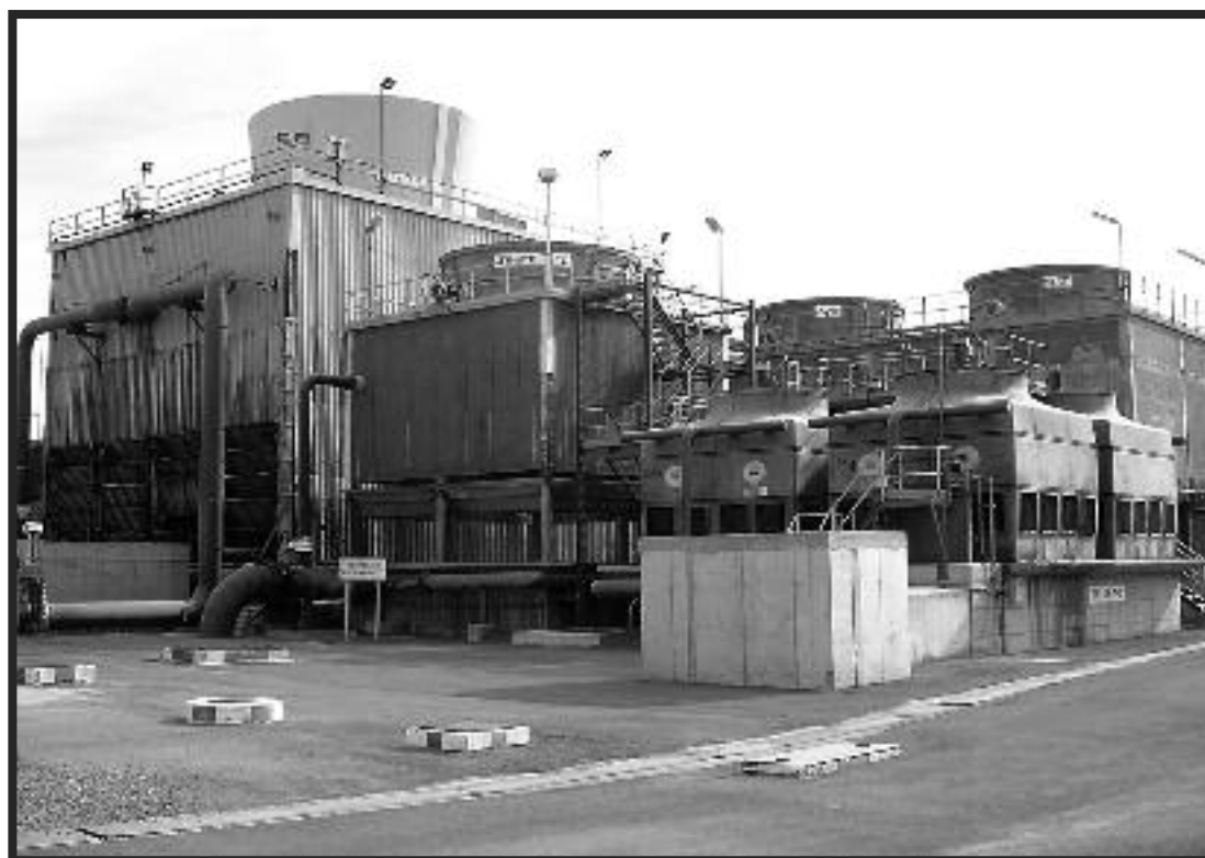
Torres de refrigeración en una industria.
